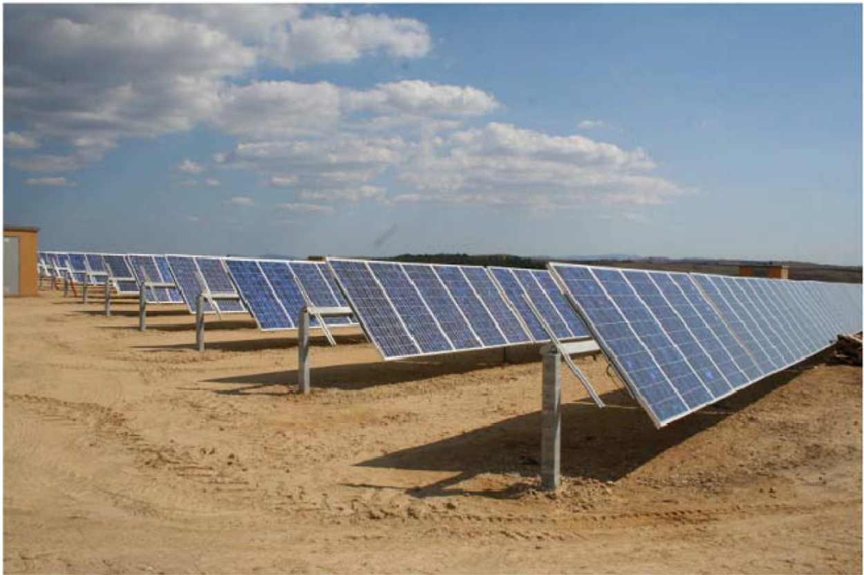
Figura 9: Ancoraggio strutture porta moduli
