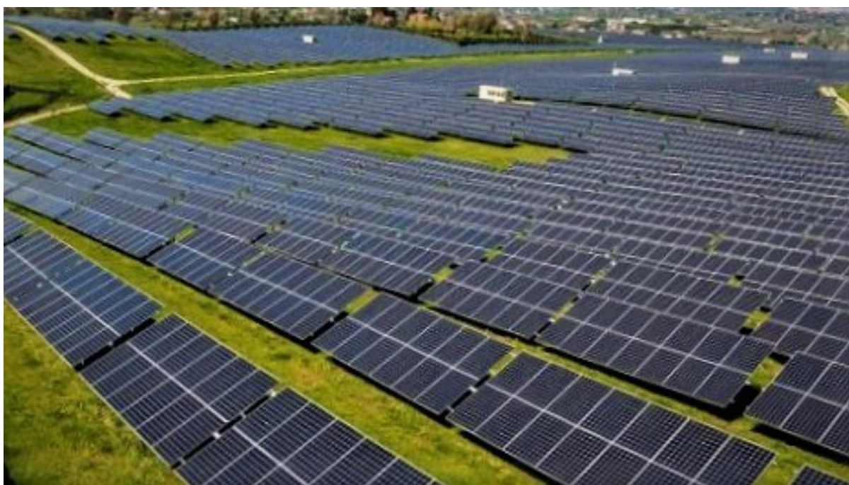
Figura 1. Esempio di impianto fotovoltaico con struttura fissa in configurazione bifilare
