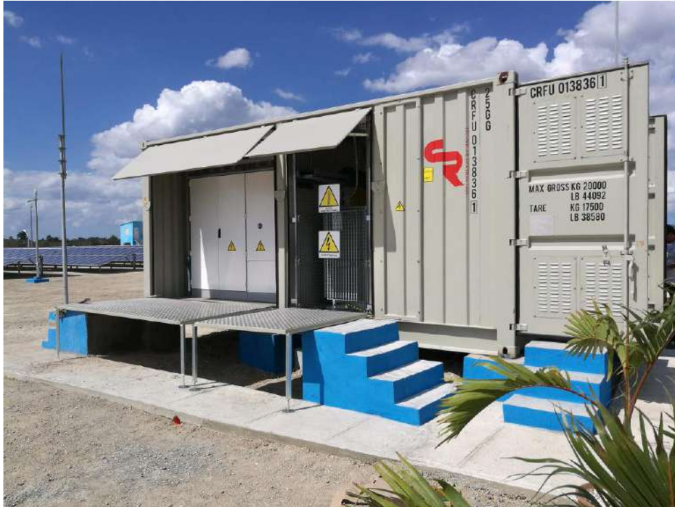
Immagine di una cabina ISO 20' contenente inverter e trasformatore
