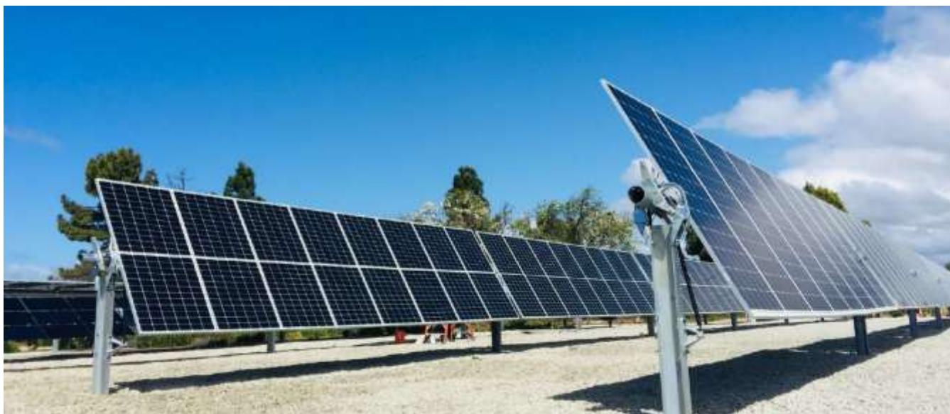
Fig. 5: Esempio di impianto fotovoltaico con i NX Navigator
