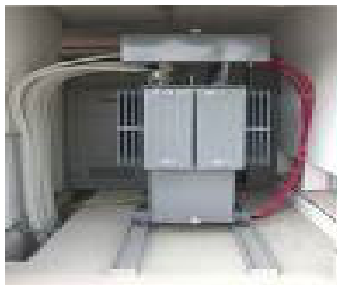
Figura 7 – esempio di cabina di trasformazione
