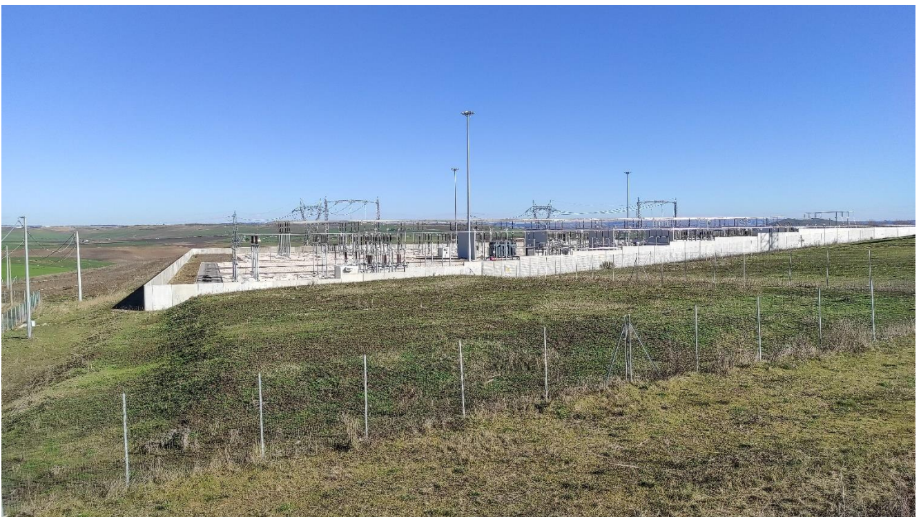
Stazione elettrica Terna esistente 380/150 kV “Genzano”
