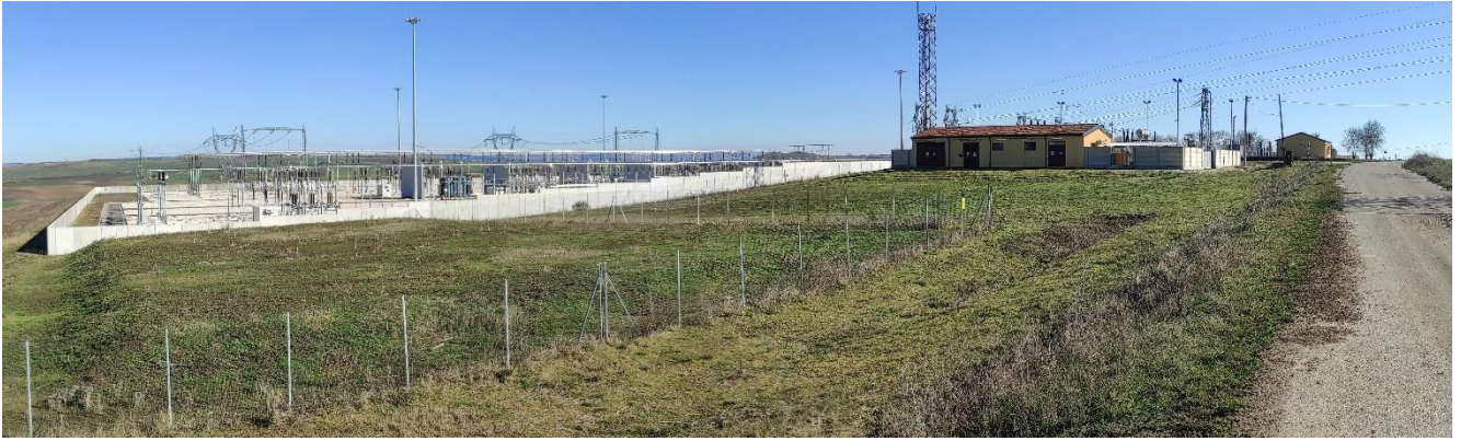
Stazione elettrica Terna esistente 380/150 kV "Genzano"
