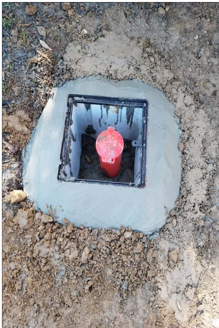
Pozzetto di protezione carrabile aperto
