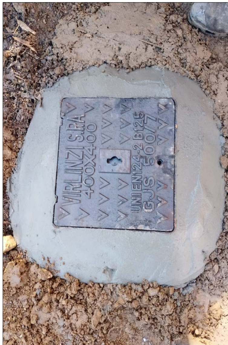
Pozzetto di protezione carrabile chiuso
