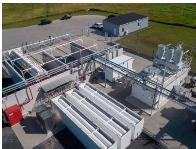
Serbatoi a forma di tubo per stoccaggio ad alta pressione
