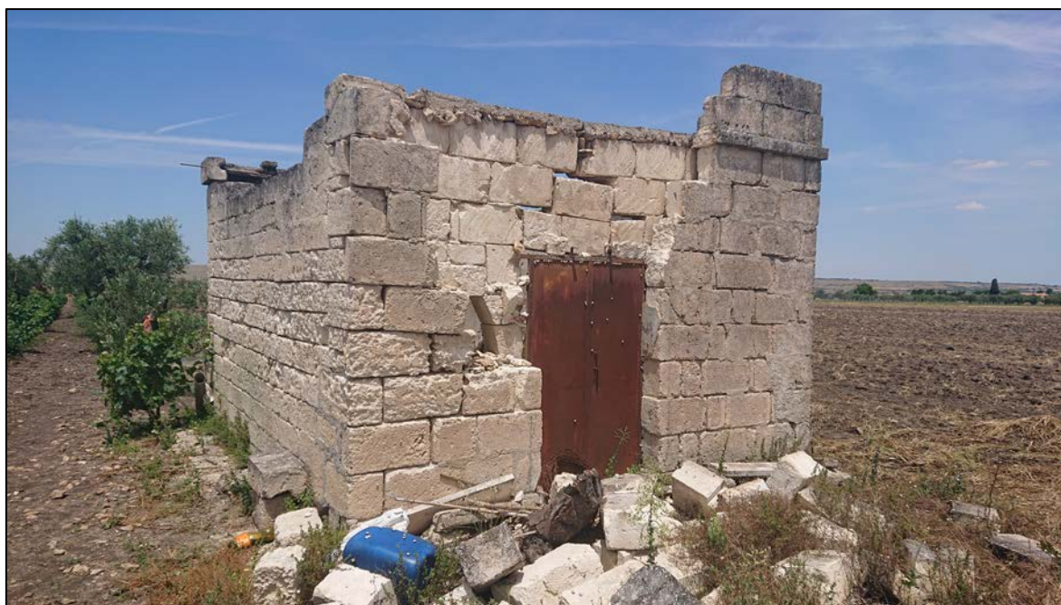
Casolare monocellulare in tufo parzialmente crollata
