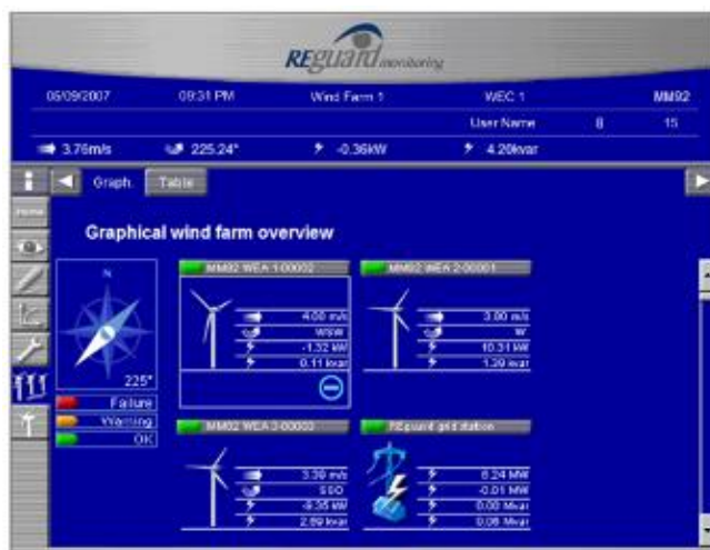
SCADA – Visualizzazione Stato del Parco Eolico.
