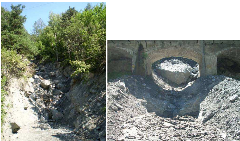
Figura 27 - dissesto idrogeologico in destra idraulica lungo l'inciso del Rio Sapè. Sono previsti interventi di consolidamento mediante formazione di scogliera in massi ciclopici
