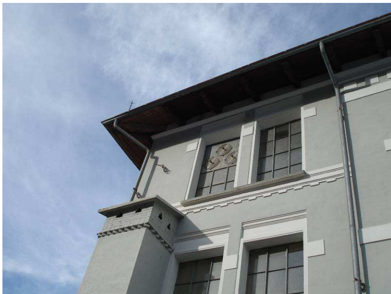
Figura 39 – dettagli dei pluviali in rame della centrale di Chiomonte riproposti nel nuovo fabbricato centrale
