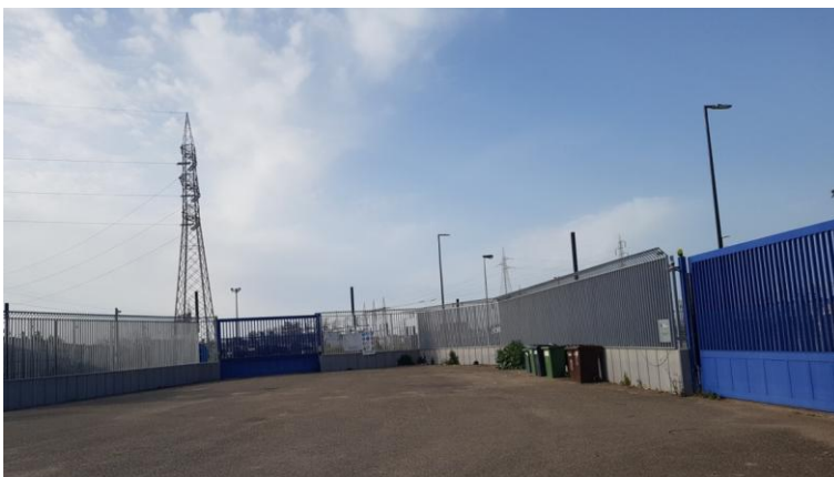
Figura 19: Vista su sottostazione Terna.
