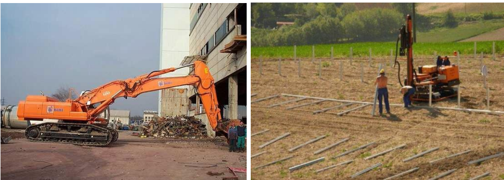
Figura 7: Esempi di macchine operatrici impegnate per la costruzione dell'impianto (Escavatore e macchina battipalo o avvitatore).
