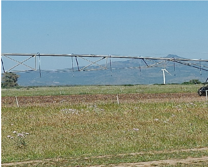
Foto n. 4: Particolare dell'impianto di irrigazione a Pivot lato Nord Est
