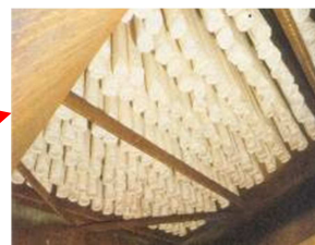
Gruppi di maniche filtranti: investite dal flusso di gas, trattengono il particolato sottile
