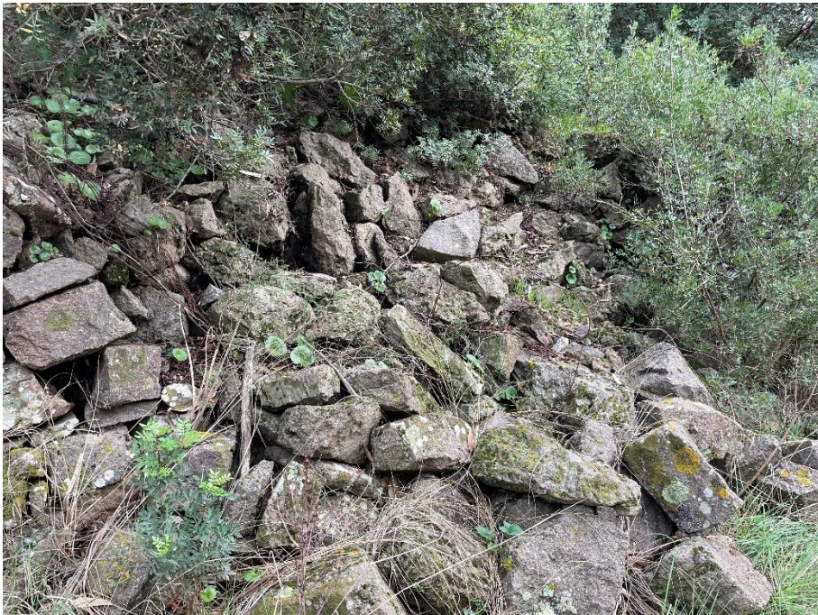
Figura 4.15 Case Miais – Muro a secco di valle parzialmente crollato – Novembre 2022
