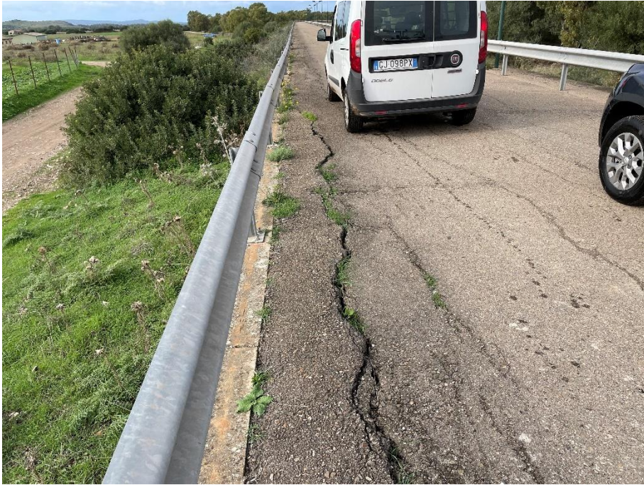
Figura 4.14 Case Miais - Fessurazioni longitudinali dell'asfalto sul coronamento lato valle in corrispondenza dell'ingresso est della diga – Novembre 2022
