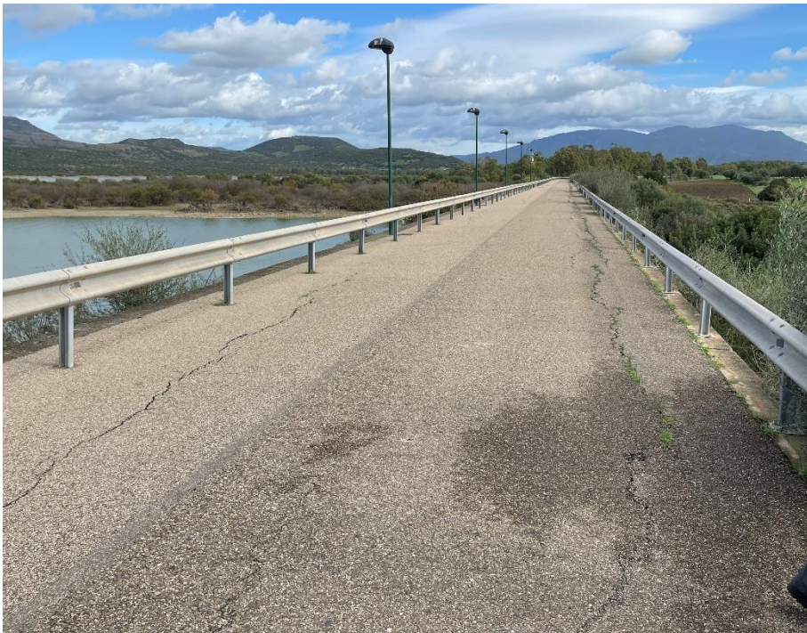
Figura 4.13 Fessurazioni longitudinali dell'asfalto sul coronamento – Novembre 2022
