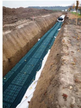
Rigofill inspect Module disposal
