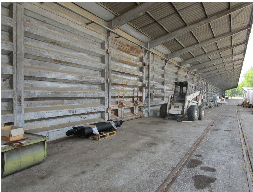
Figura 1.2: Foto dello stato attuale della copertura a sbalzo annessa al capannone
