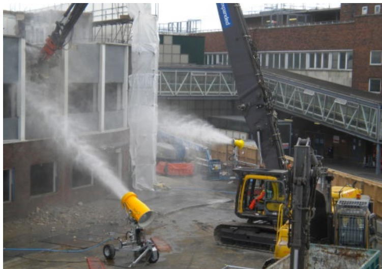
Figura 25 – Esempio di sistemi di abbattimento polveri in funzione durante le operazioni di demolizione
