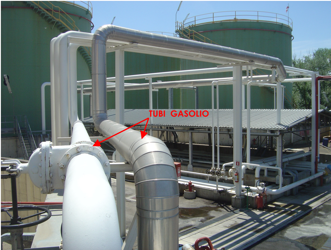
Deposito Abruzzo Costiero – dettagli percorsi tubazioni
