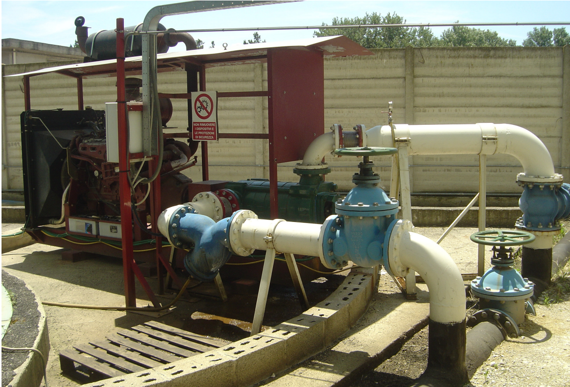
Deposito Abruzzo Costiero – motopompa acqua esistente
