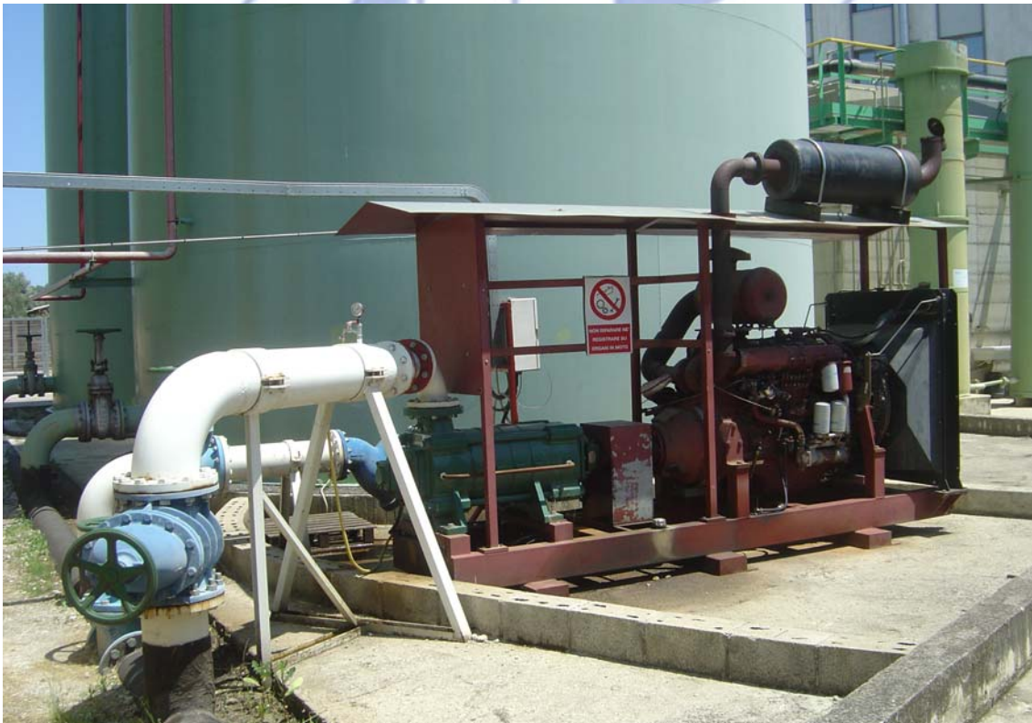
Deposito Abruzzo Costiero – motopompa acqua esistente
