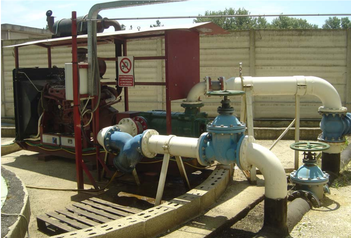
Deposito Abruzzo Costiero – motopompa acqua esistente
