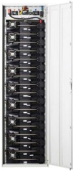
Fig.28: Esempio rack batterie
