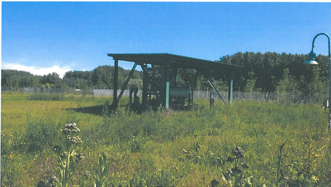
Fotografia 2: Tettoia stoccaggio metanolo – area pozzi 7/44
