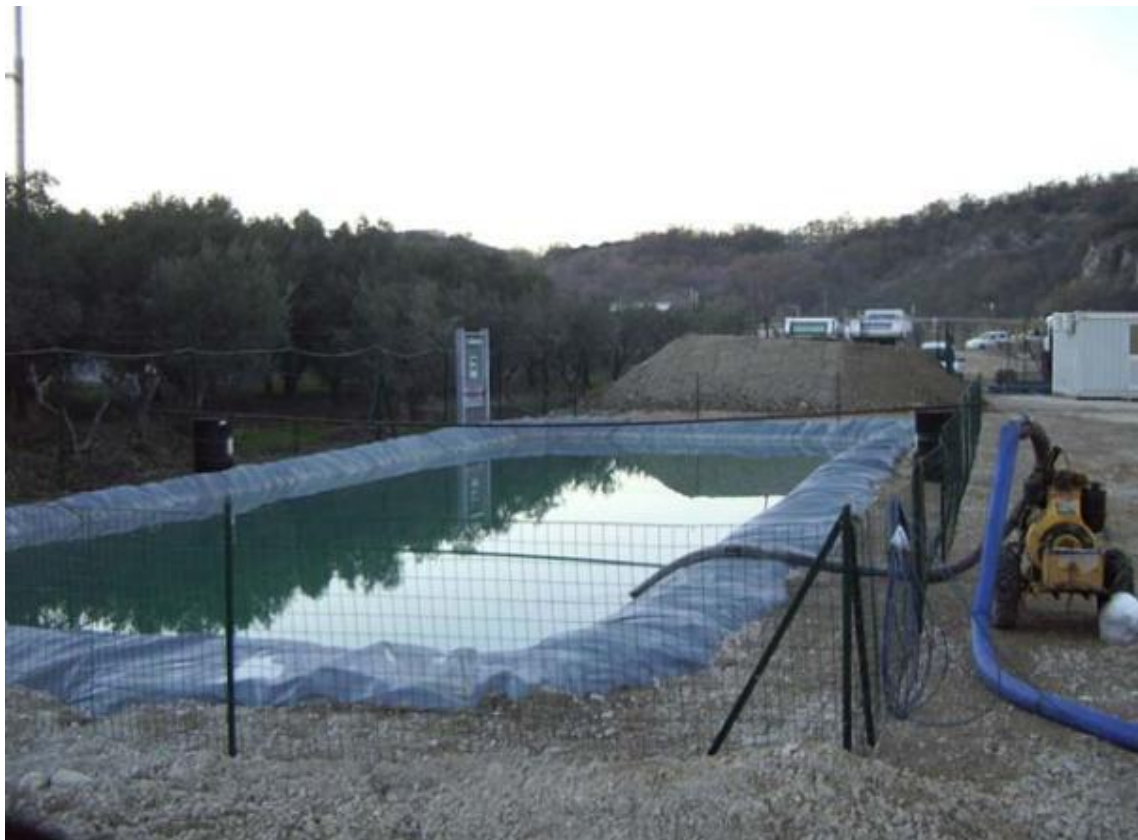
Figura 6-14 Vascone per lo Stoccaggio in Cantiere dell'Acqua Industriale
