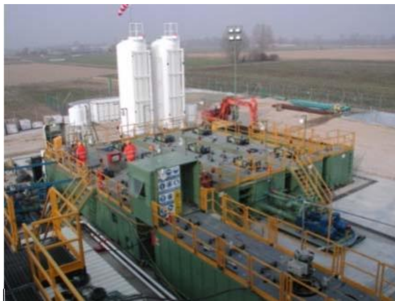
Figura 6-7 Impianto di perforazione HH220: circuito fango
