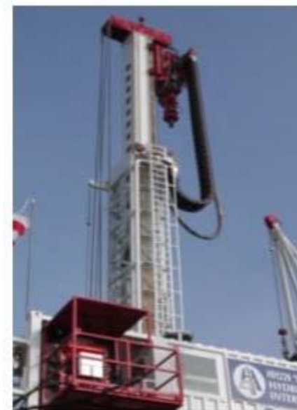
Figura 6-5 Impianto di perforazione HH220: sistema di sollevamento
