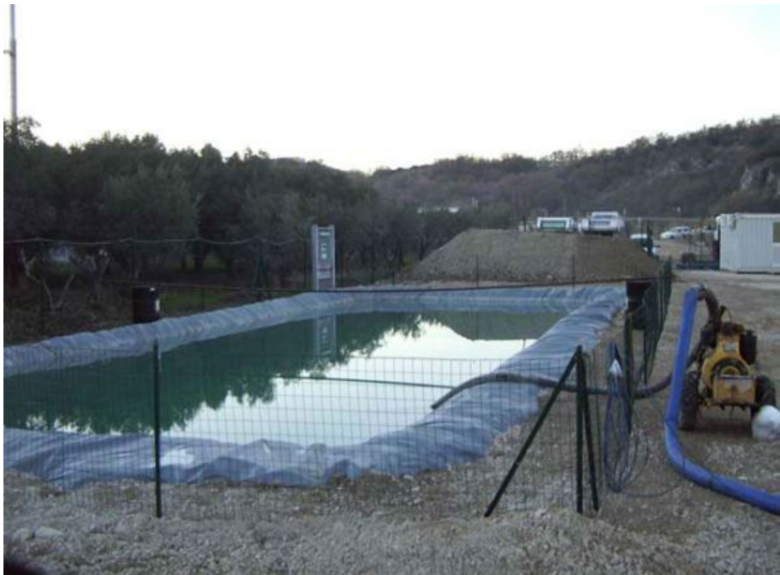
Figura 3-46 Vascone per lo Stoccaggio in Cantiere dell'Acqua Industriale
