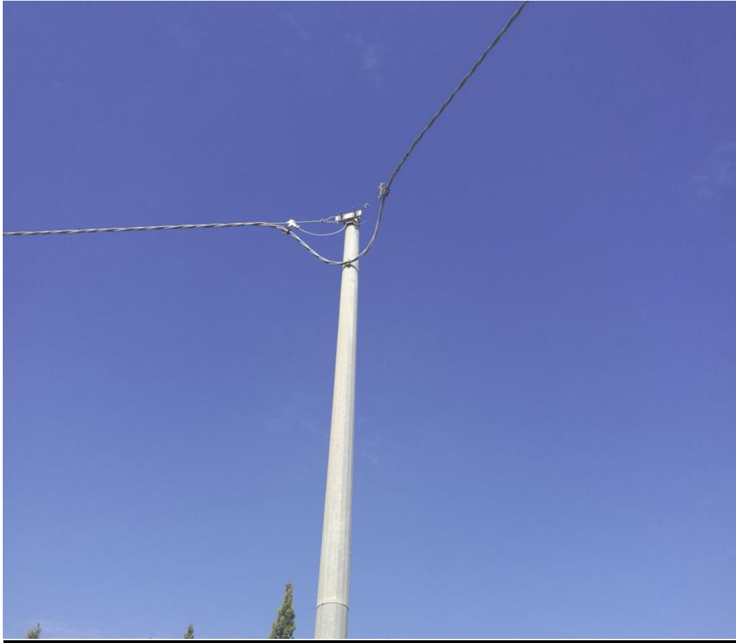
Particolare di armamento in amarro doppio con deviazione linea (sostegno n. 7)
