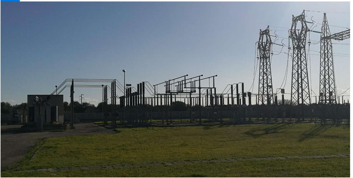
CP Mesagne: Cabina Primaria esistente (vista longitudinale)
