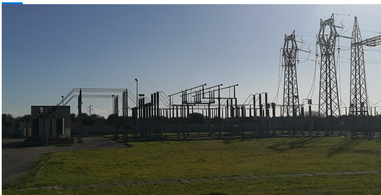
CP Mesagne: Cabina Primaria esistente (vista longitudinale)
