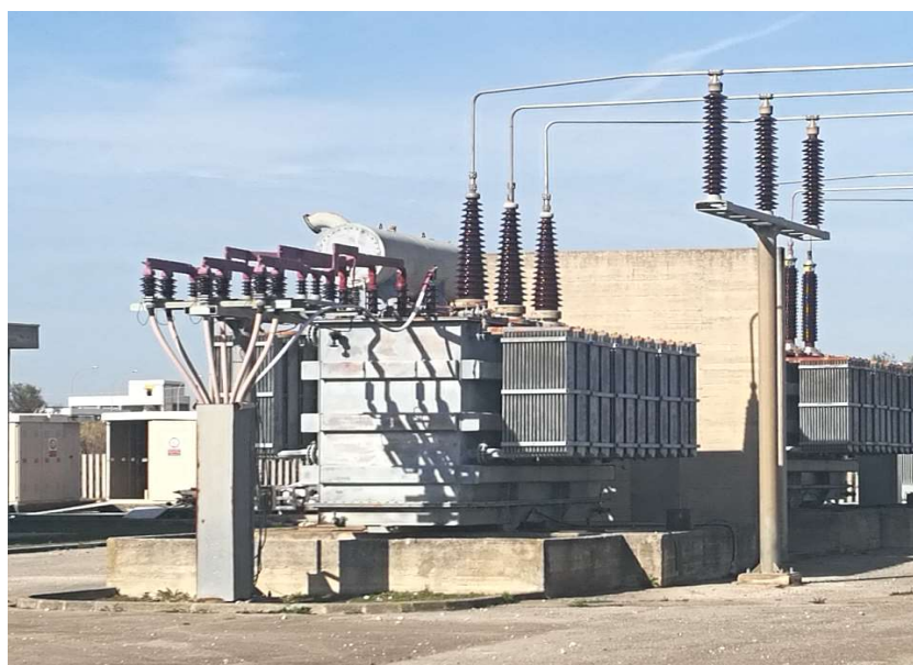
Tipico trasformatore di potenza AT/MT ONAN
