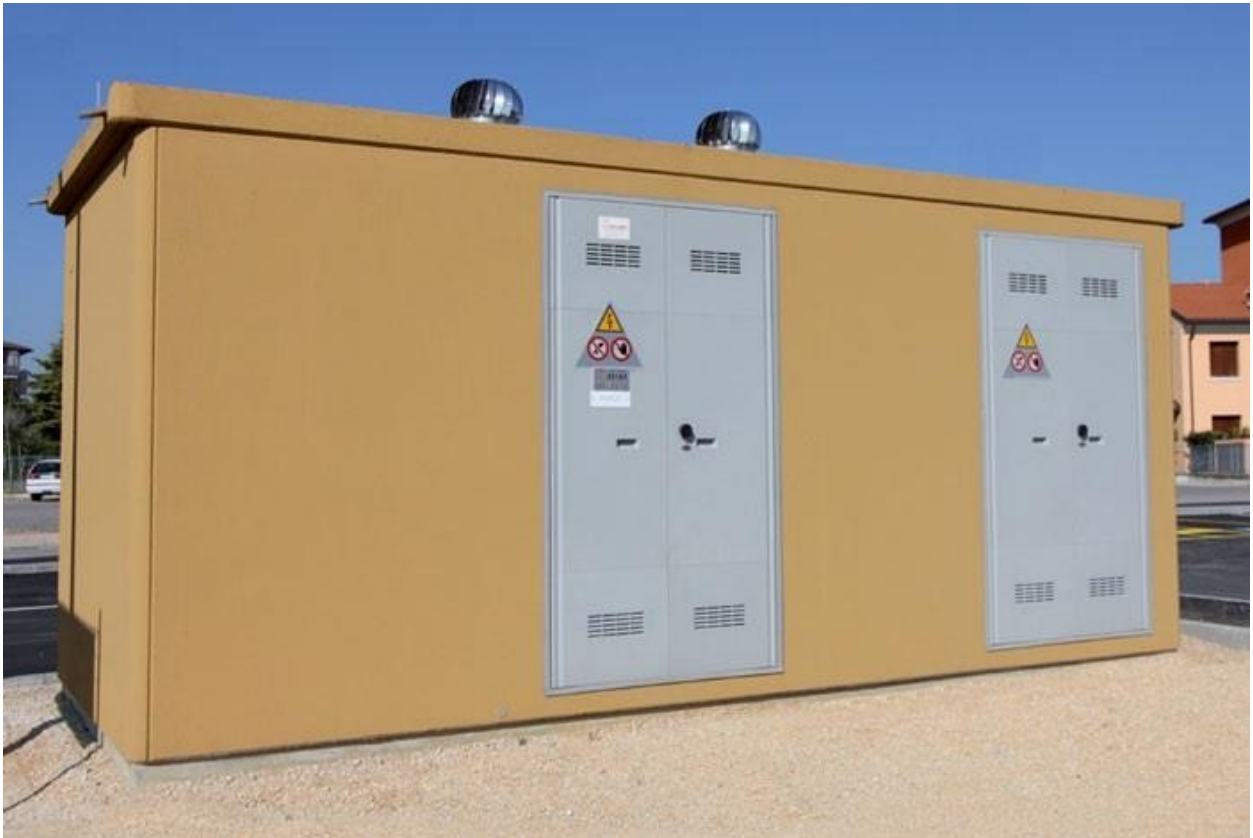
Figura 35 Tipica cabina prefabbricata
