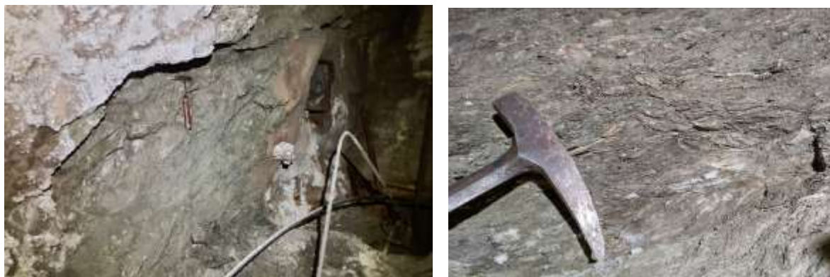
Figura 23: Aspetto del Bisciario nel rilievo geomeccanico eseguito nella zona della centrale (RG-SG01)
