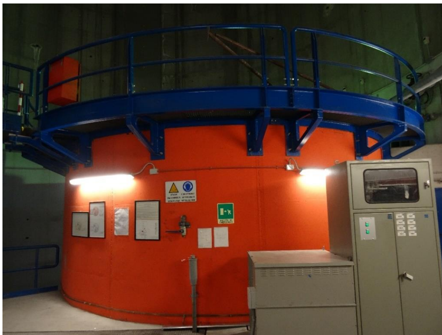
Figura 16: C.le San Giacomo II - interni - sala macchina Gr.6
