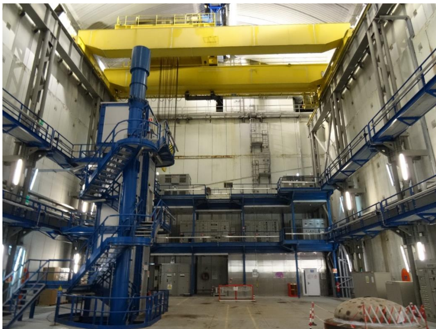
Figura 18: C.le San Giacomo II - interni - sala macchine – carroponete
