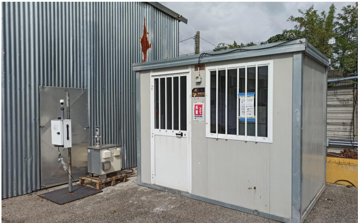
Immagine 2.2: Campionatore gravimetrico installato a fianco al polverimetro
