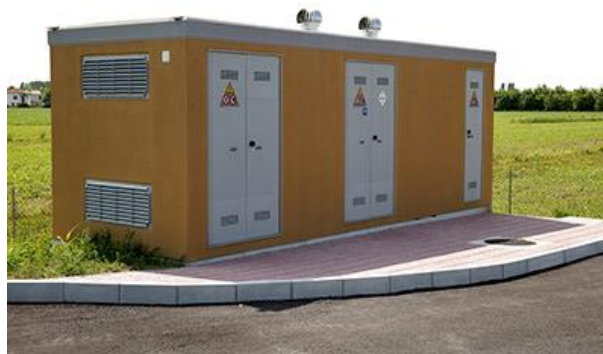
Cabine elettriche standard
