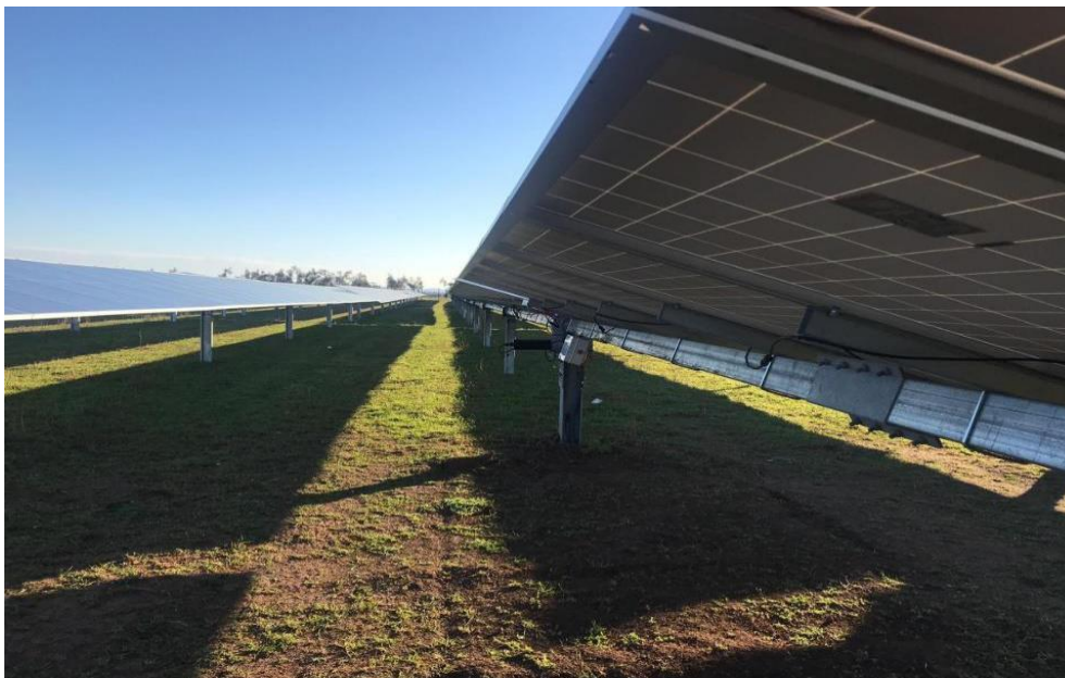
FIG. 29 - VISTA GENERALE INSTALLAZIONE PANNELLI FOTOVOLTAICI SU INSEGUITORI
