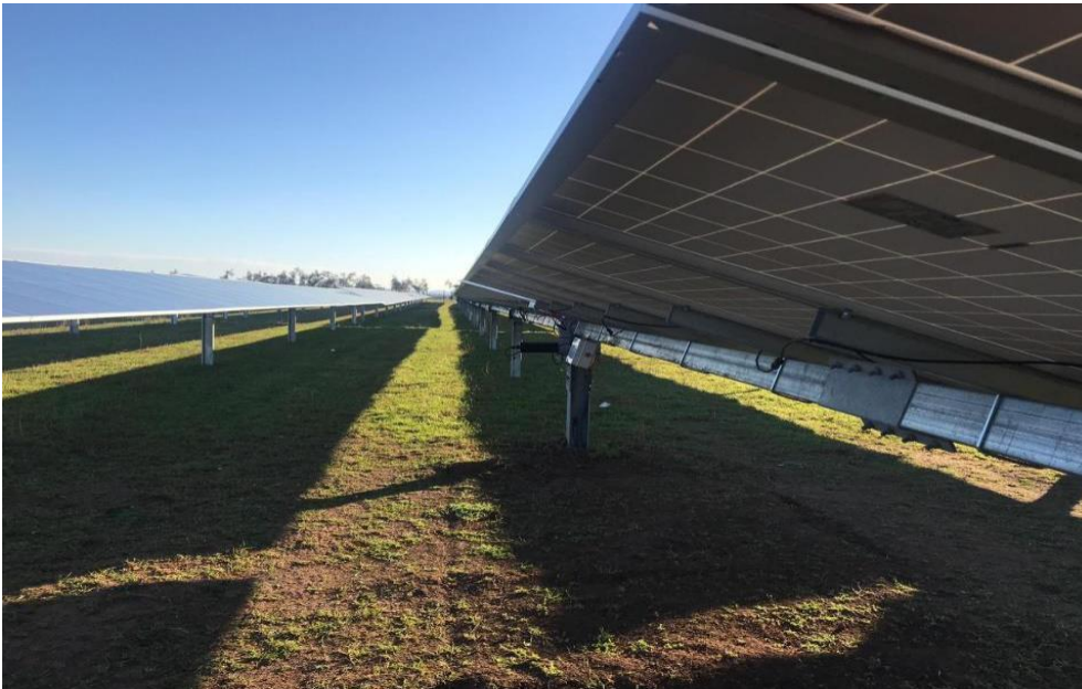
Fig. 9 VISTA GENERALE INSTALLAZIONE PANNELLI FOTOVOLTAICI SU INSEGUITORI TIPO
