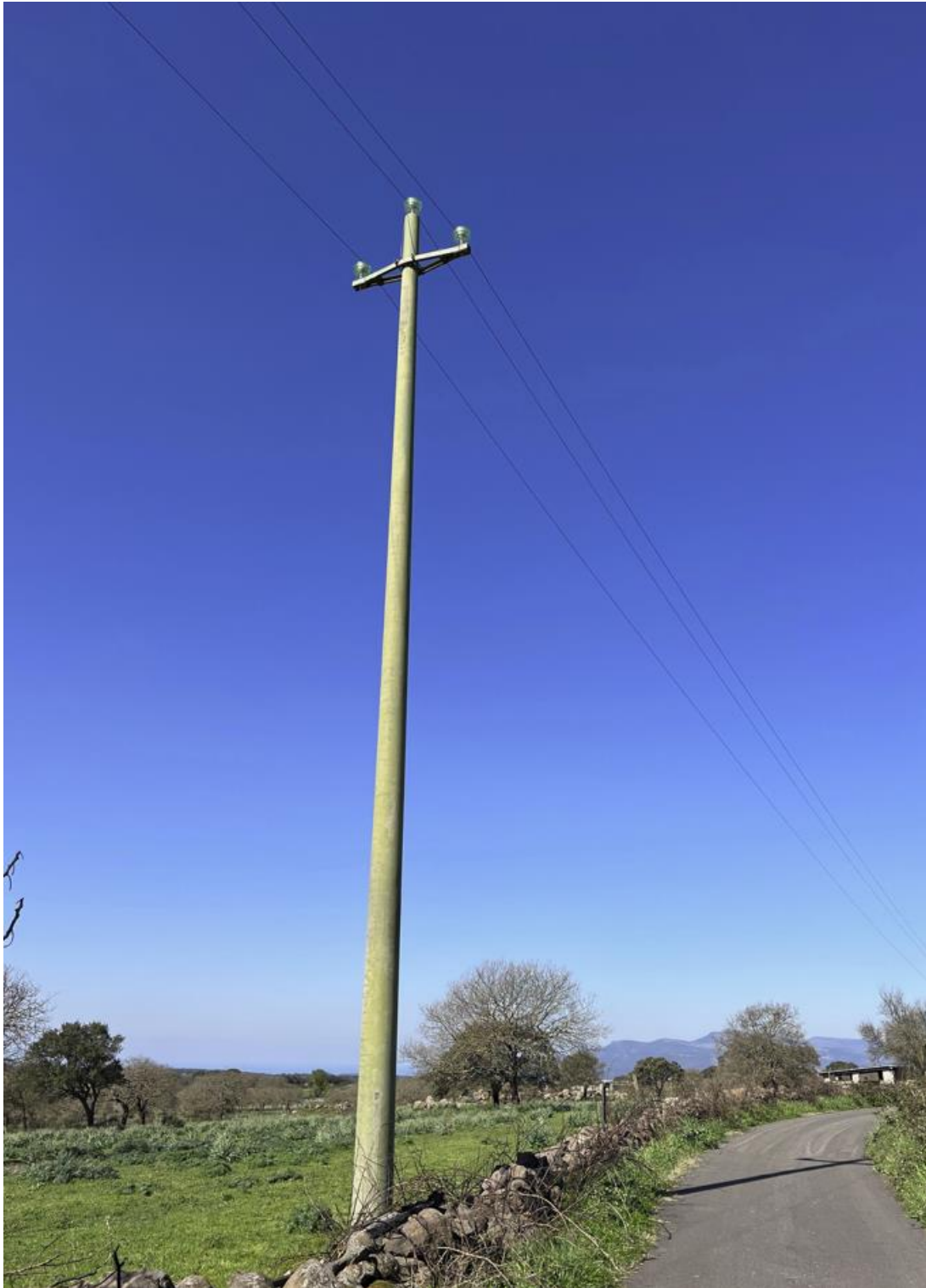
Figura 19. Foto da sopralluogo attraversamento di linea elettrica MT lungo il tracciato di collegamento con le WTG SUNI 2 (467583.12 m E, 4461611.75 m N).
