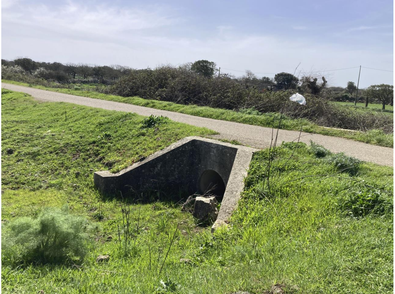
Figura 11. Foto da sopralluogo interferenza opere idrauliche (470520.49 m E, 4457917.71 m N).
