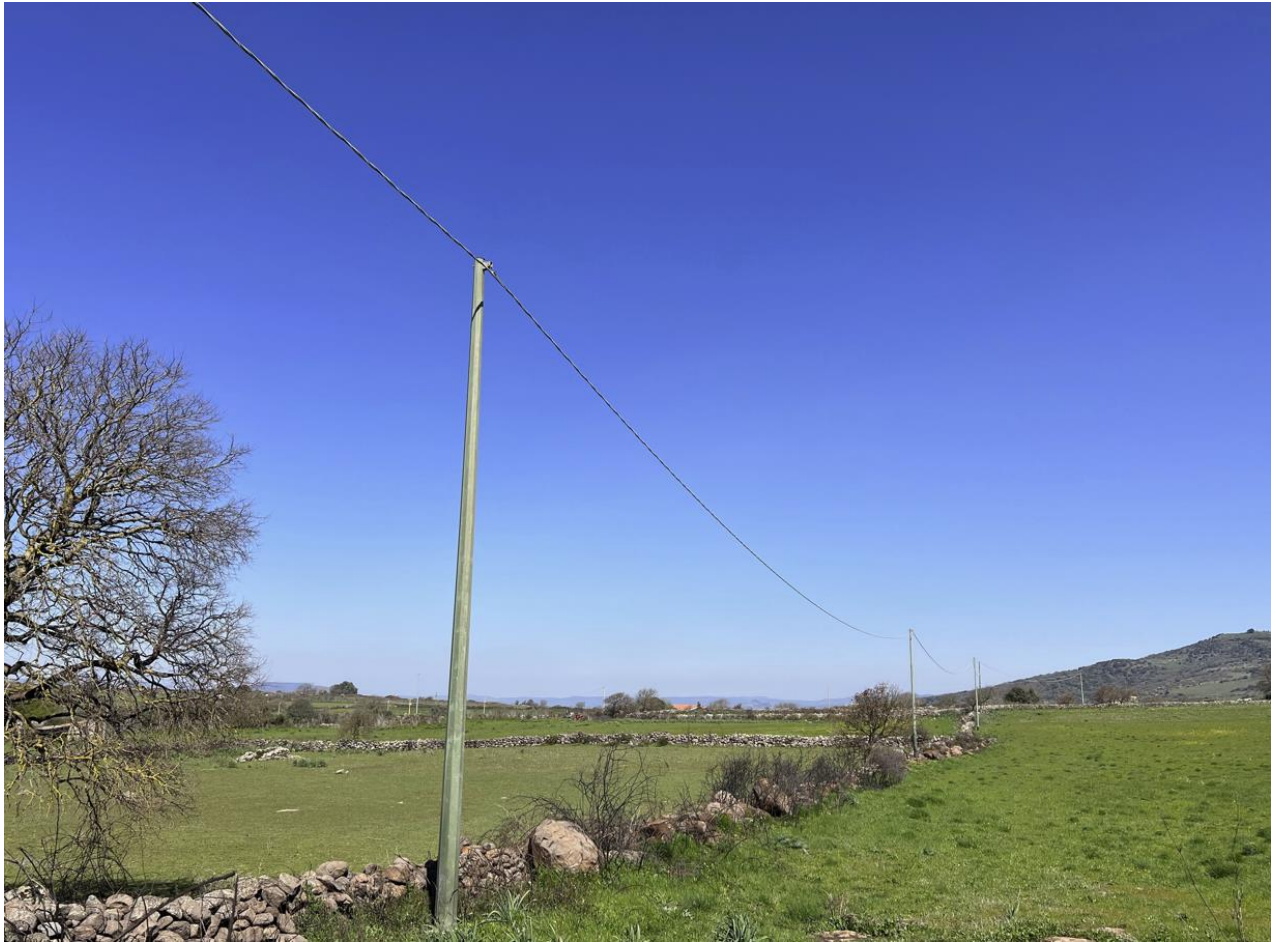
Figura 18. Foto da sopralluogo, attraversamento di linea elettrica BT e MT lungo il tracciato da adeguare per di collegamento con le WTG e cabina raccolta (469262.19 m E, 4460248.25 m N)
