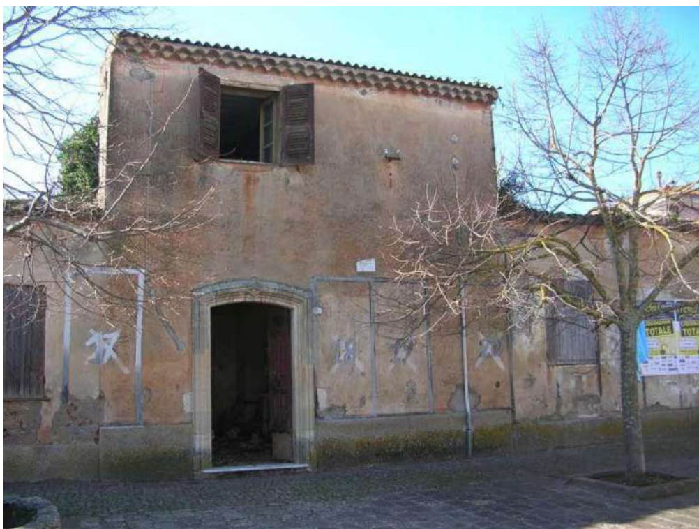
Figura 106: Fabbricato "Giudice Meloni" (id bene: 3754509), Bene archeologico di interesse culturale dichiarato, Comune di Padria.
