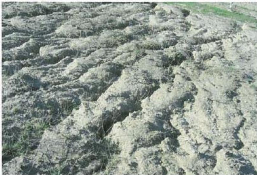
Figura 65: Forme erosive sulla sponda destra dell'invaso del Rendina (Potenza)
