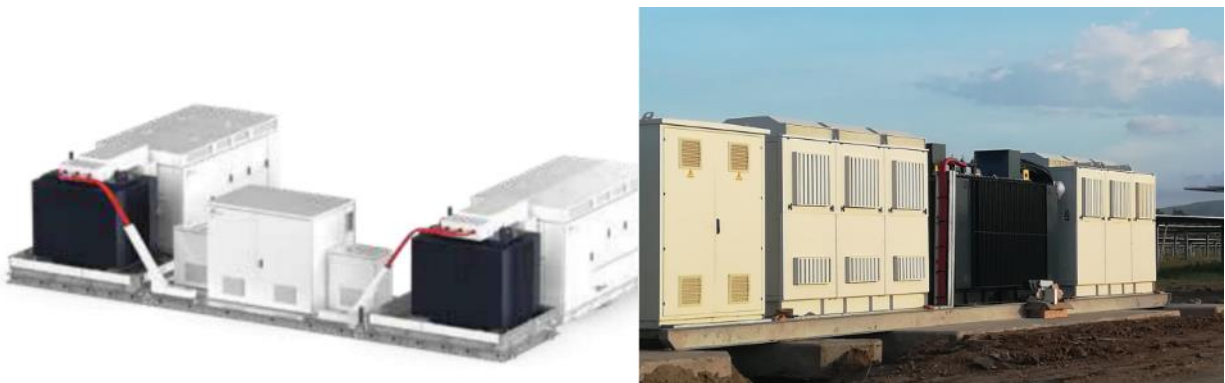
Figura 15 esempio di stazioni di Potenza MT a servizio dello storage
