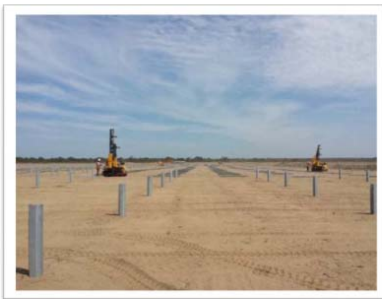
Figura 11 – Foto esempio di impianto realizzati con stessa struttura e stessi moduli fotovoltaici
