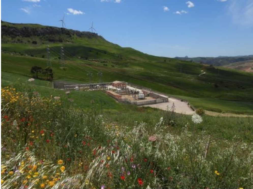
Stazione elettrica esistente di Marianopoli
