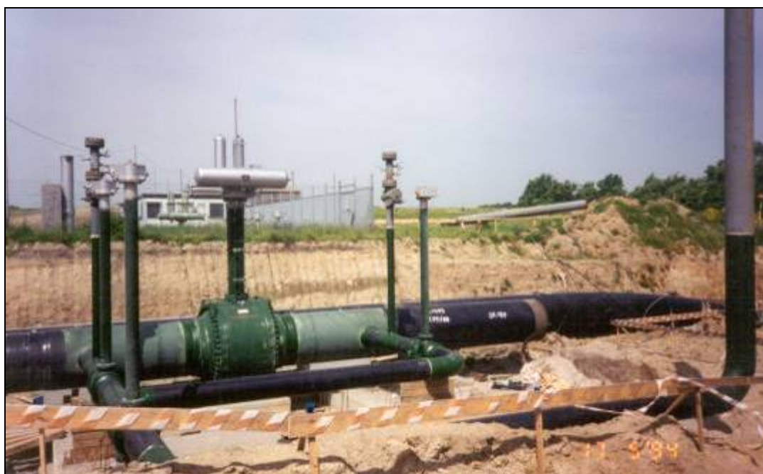
Foto 2.2-8: Esempio di punto di intercettazione di linea (PIL)
