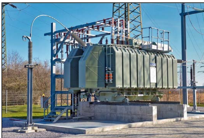
Esempio di vasca di raccolta olio isolante Trasformatore. (Fonte: web)
