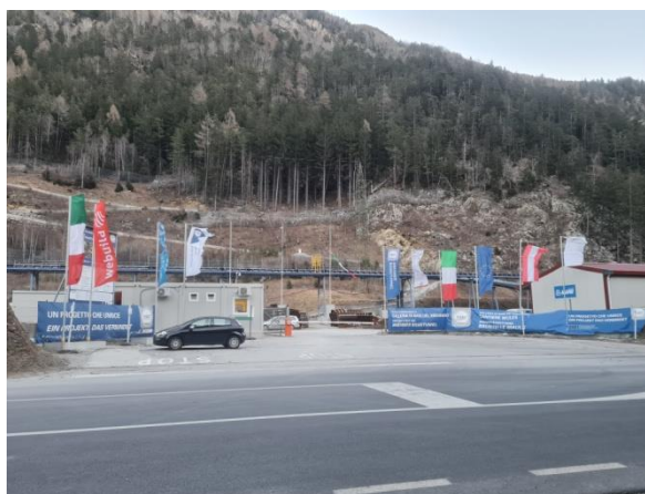
Reti paramassi sul versante che sovrasta il cantiere
