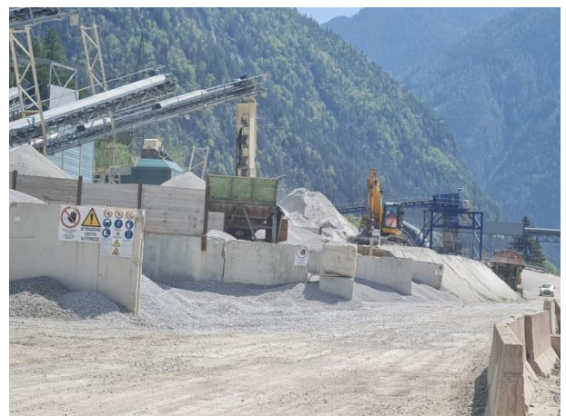
Anlage für Zuschlagstoffe
