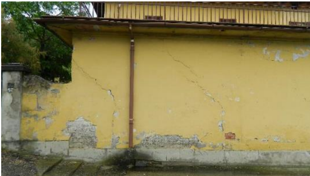
Figura 12-5 – Lesioni su edificio in località Le Coste
