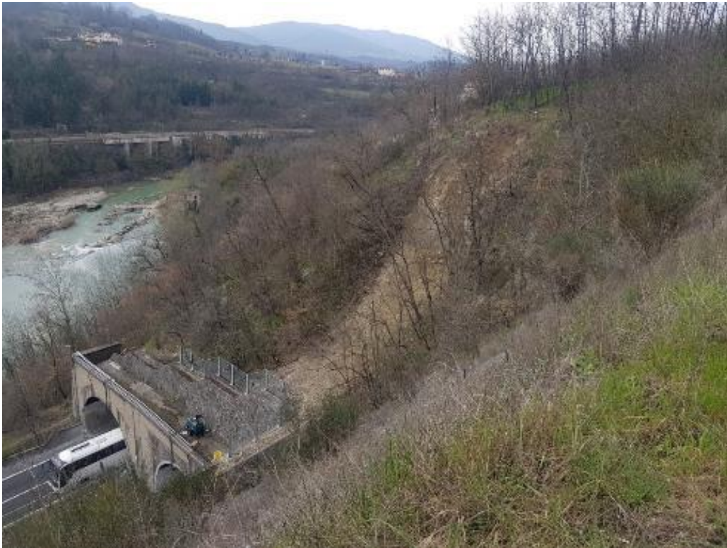
Figura 5-7 – Caduta massi avvenuta nel marzo 2018 al di sopra dell'imbocco sud della galleria Bruschetto.
