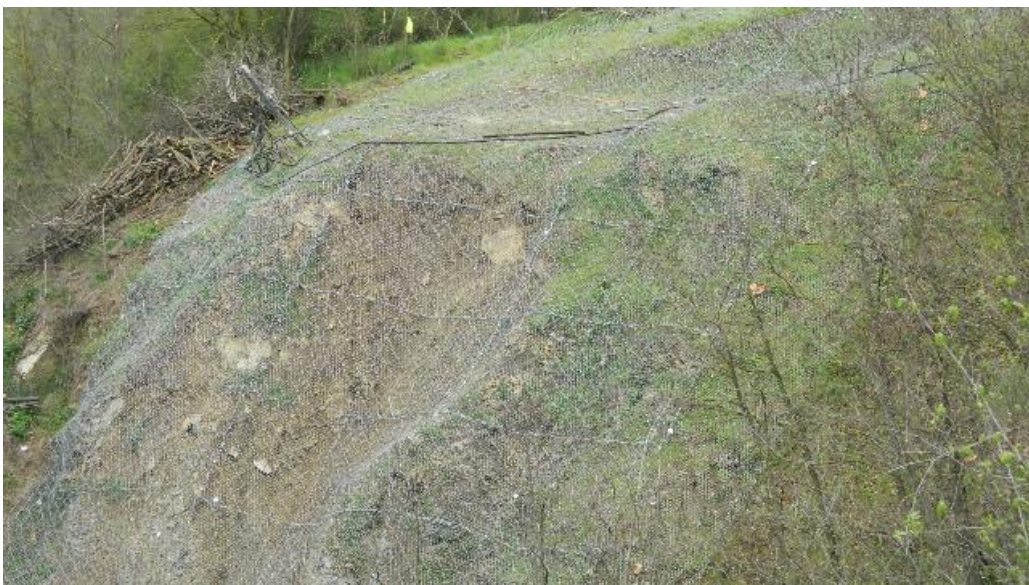
Figura 5-8 – Interventi di messa in sicurezza al di sopra dell'imbocco sud della galleria Bruschetto.
