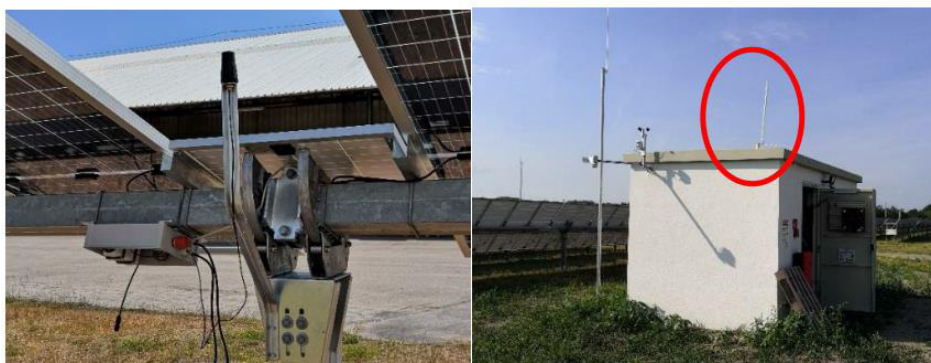
Figure 5.3: Esempio di collegamento - L'antenna TP sul tracker (a sinistra) e l'antenna del RP nella parte superiore della stazione di trasformazione (a destra)
