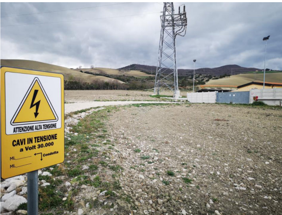
FOTO 4 (FOTO REPERTORIO MAGGIO 2020): SSE, VISTA DA E. AREA SSE /CABINA, DETTAGLIO ELETTRODOTTI PREESISTENTI.
