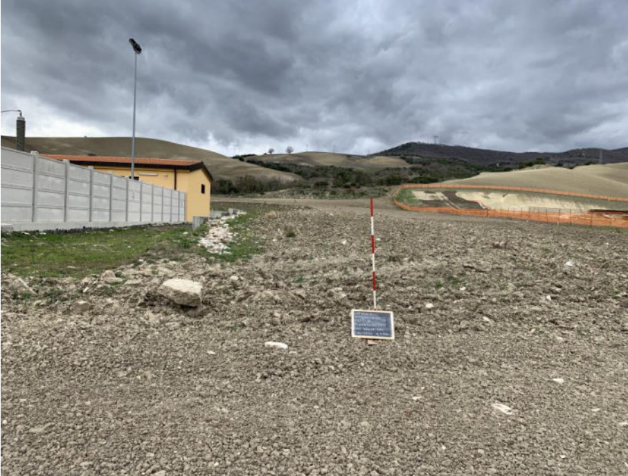
FOTO 3 (FOTO REPERTORIO MAGGIO 2020): SSE, VISTA DA N. AREA SSE /CABINA.CANTIERE TERNA ANCORA IN ITINERE.
