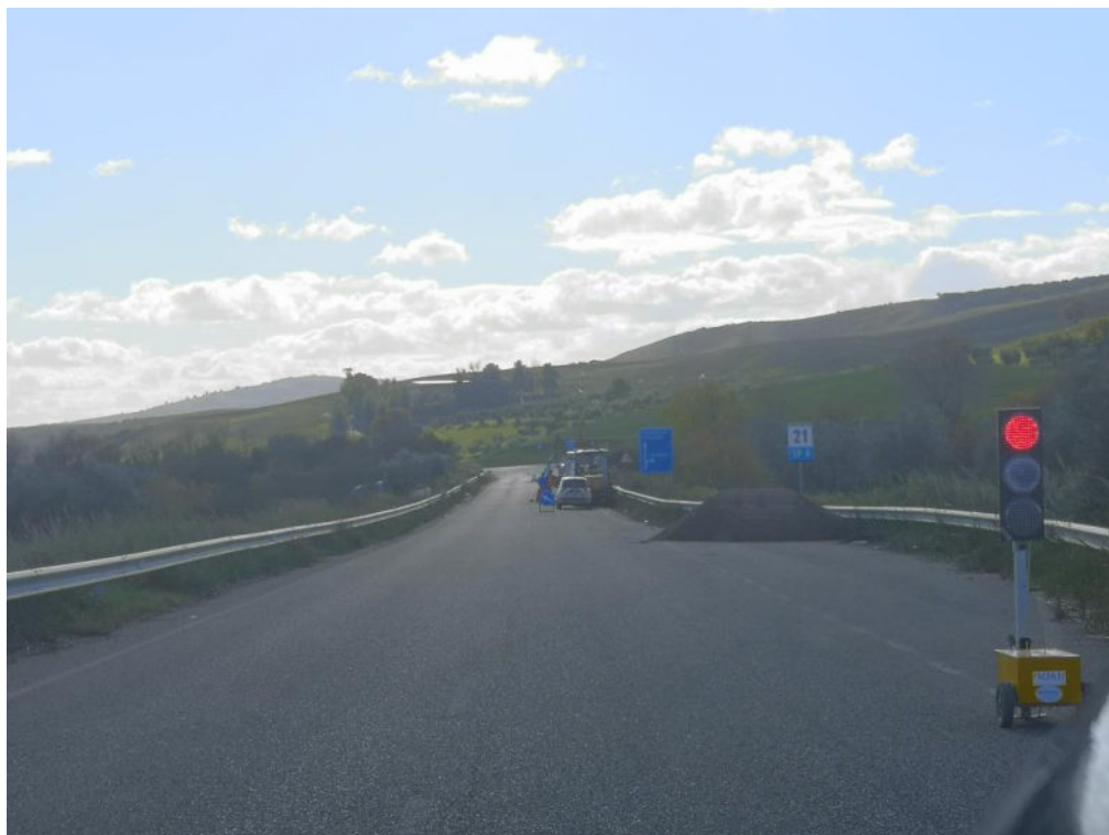
FOTO 16: CAVIDOTTO LUNGO SP4.
