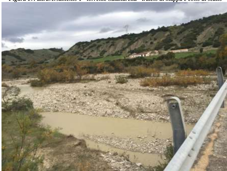
Figura 20: attraversamento 1 – vista da valle verso monte della sponda in sinistra idraulica – tratto alluvionato pluricorsale
