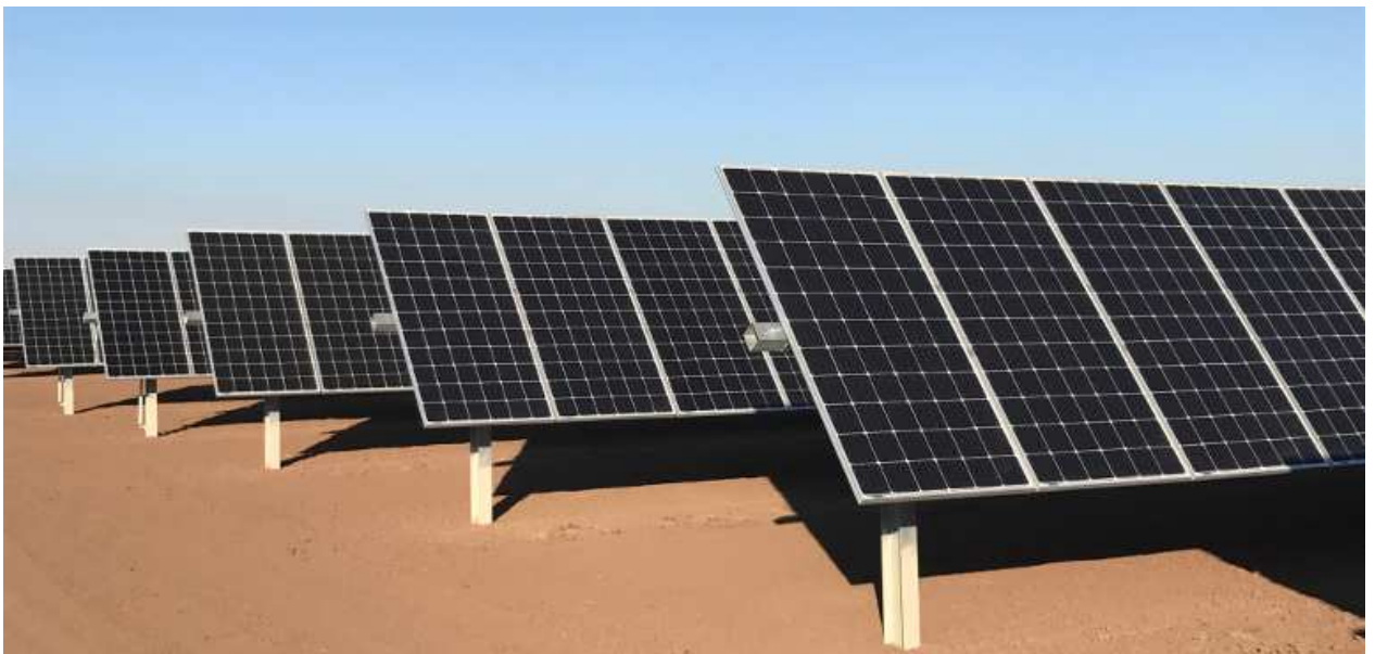
Strutture di supporto "Tracker mono-assiale"
