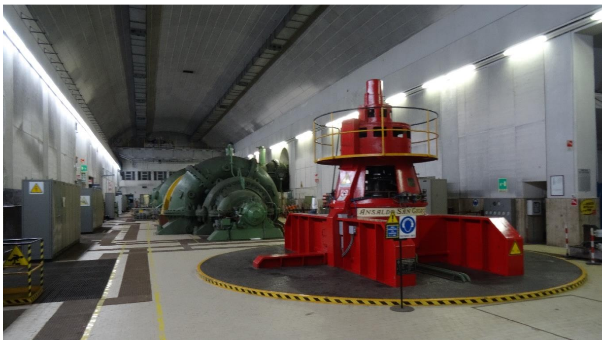
Figura 23: Centrale di Provvidenza - Sala macchine
