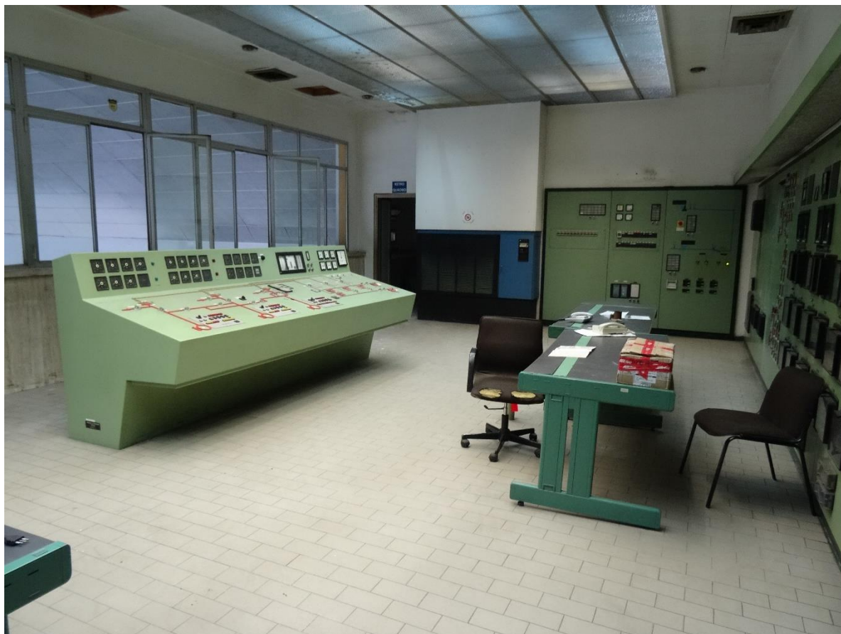
Figura 26: Centrale di Provvidenza – sala controllo
