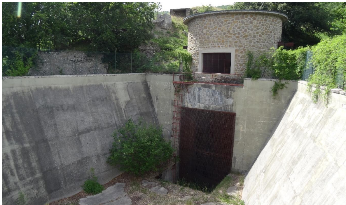
Figura 10: Pozzo Piezometrico - Vasca di espansione all'aperto – interno
