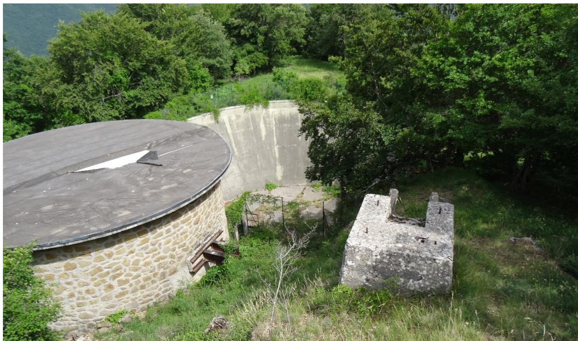
Figura 9: Pozzo Piezometrico - Vasca di espansione all'aperto
