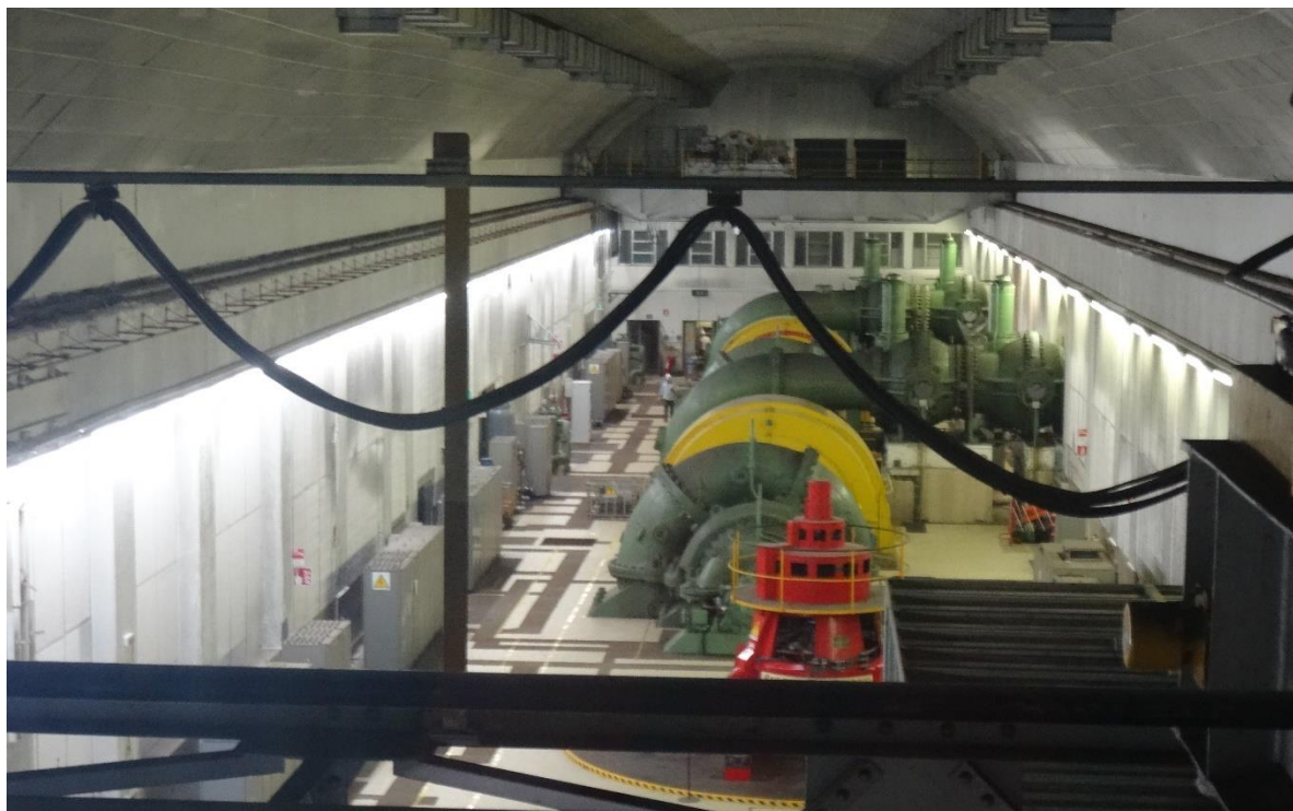
Figura 24: Centrale di Provvidenza - Sala macchine vista dall'alto
