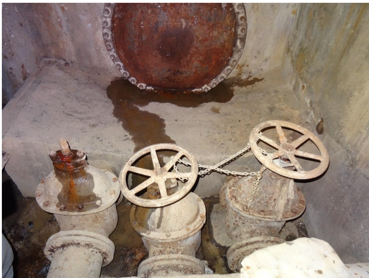
Figura 15: Finestra di accesso: valvole di vuotamento e passo d'uomo per l'accesso alla galleria di adduzione
