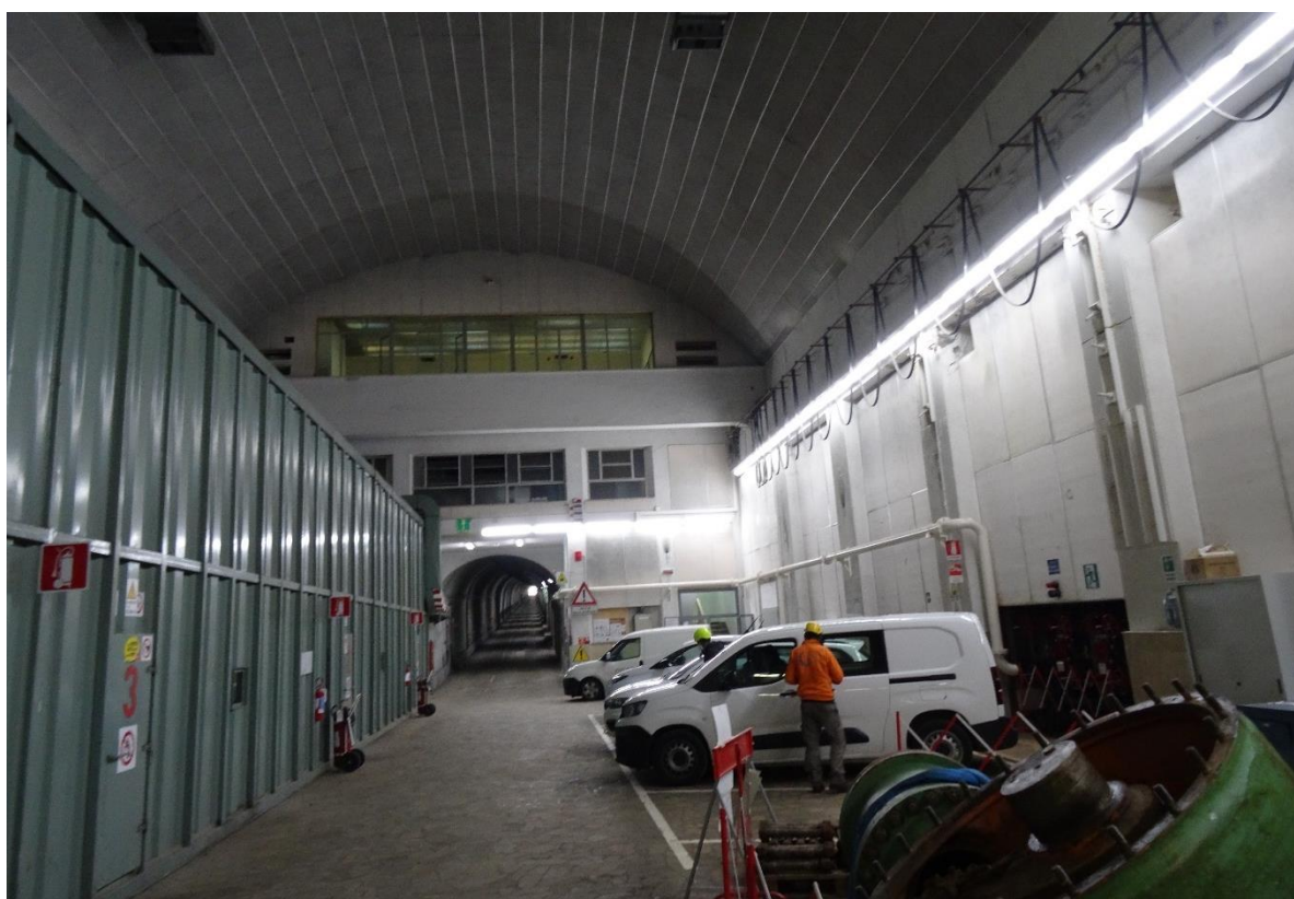
Figura 25: Centrale di Provvidenza – vista su trasformatori (a sinistra), galleria di accesso e sala controllo (in alto)
