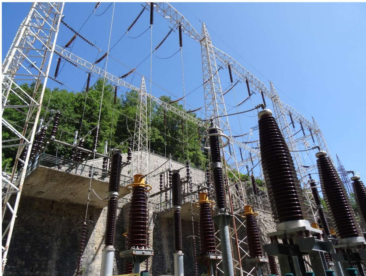
Figura 22: Centrale di Provvidenza – sottostazione – dettaglio apparecchiature
